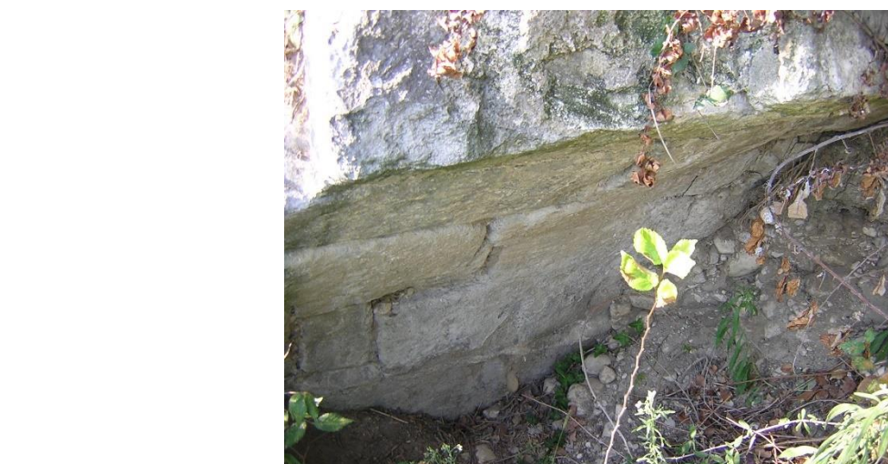
Fig. 75. Faicchio, loc. Porto: particolare dei resti del ponte in opera quadrata sul Titerno.
