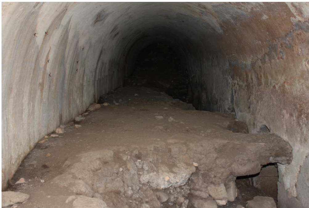
Fig. 65. La galleria settentrionale, in parte invasa da limo e pietrame.
